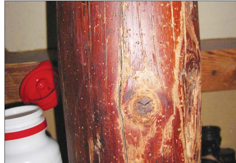
"Niet relevante aantasting door insecten in gebint demonstratiepand Buitenbedrijf BBZ. Het betreft hier een spar uit 1878. Er is geen bestrijding uitgevoerd." © J. Doevendans Groningen
