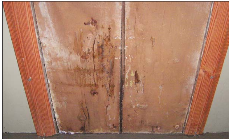
"Niet relevante aantasting door "zwam" in plafond demonstratiepand Buitenbedrijf BBZ. Het betreft hier een plank uit 1903. Er is geen bestrijding uitgevoerd." © J. Doevendans Groningen
