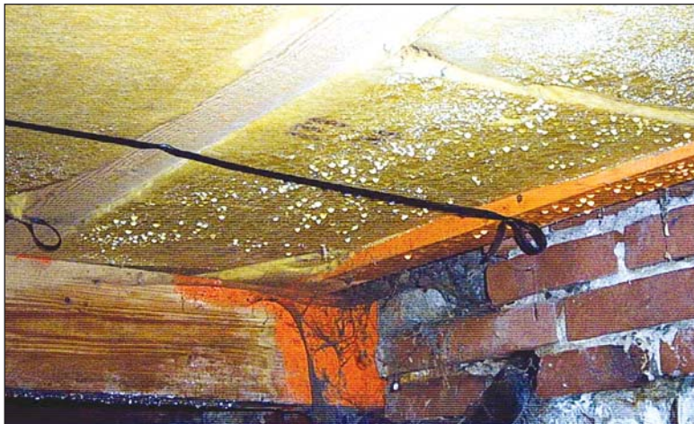
's Winters méér ventileren geeft méér condens! Let op de extra aangebrachte renovatiekoker. copyright + foto: Buitenbedrijf BBZ Groningen.
